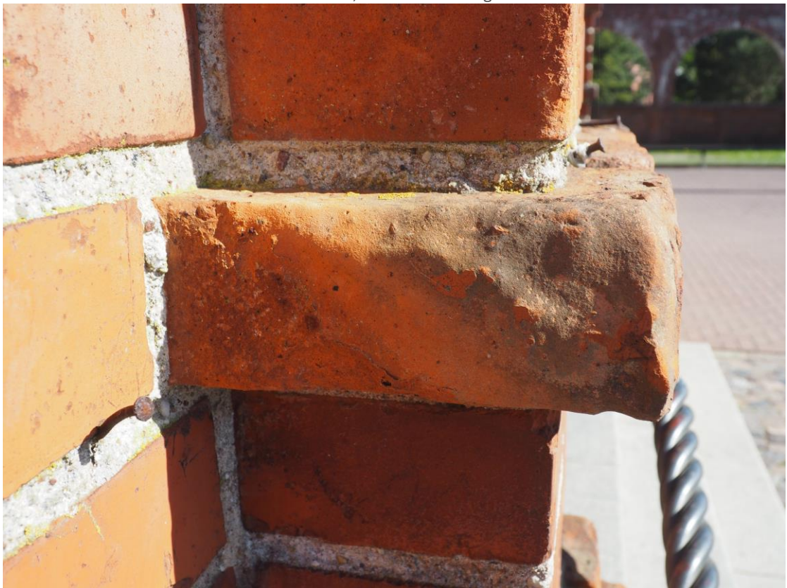
Fot. 11. Wygoda łączyńska, kościół PW. Św. Józefa. Elewacja zachodnia – fasada. Północne ościeże ryzalitu. Widoczna spudrowana cegła.
