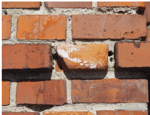
Il. 7. Wysolenie widoczne na pojedynczej cegle.
