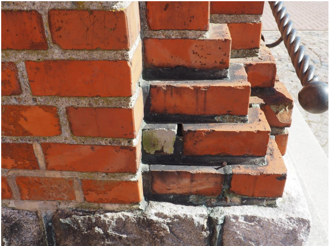
Fot. 12. Wygoda Łączyńska, kościół PW. Św. Józefa. Elewacja zachodnia – fasada. Północne ościeże ryzalitu. Widoczny wykwit solny; kolonie mikroorganizmów; nawarstwienia zanieczyszczeń.
