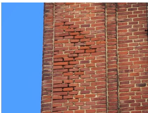
Il. 10. Poważne ubytki zaprawy spoinowej widoczne na zachodniej elewacji wieży.
