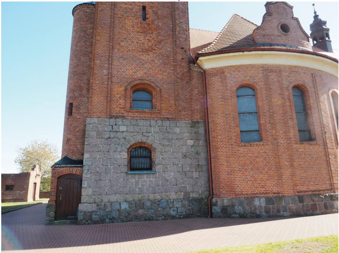
Fot. 22. Wygoda Łączyńska, kościół PW. Św. Józefa. Północna elewacja transeptu i wieży. Widoczny stan lica wieży pomiędzy II i III kondygnacją.
