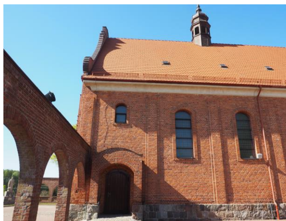
Il. 13. Uszkodzenia na powierzchni arkad.
