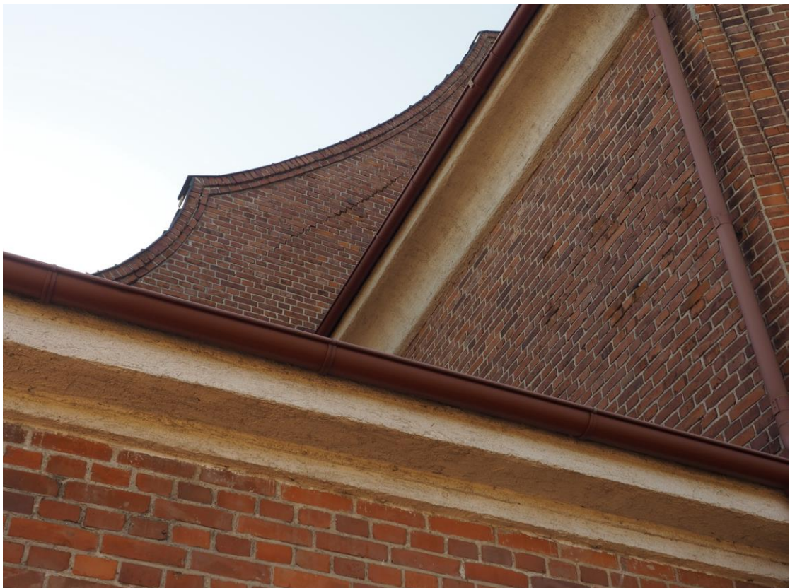
Fot. 28. Wygoda łączyńska, kościół PW. Św. Józefa. Szczyt wschodni. Widok od południowego wschodu.
