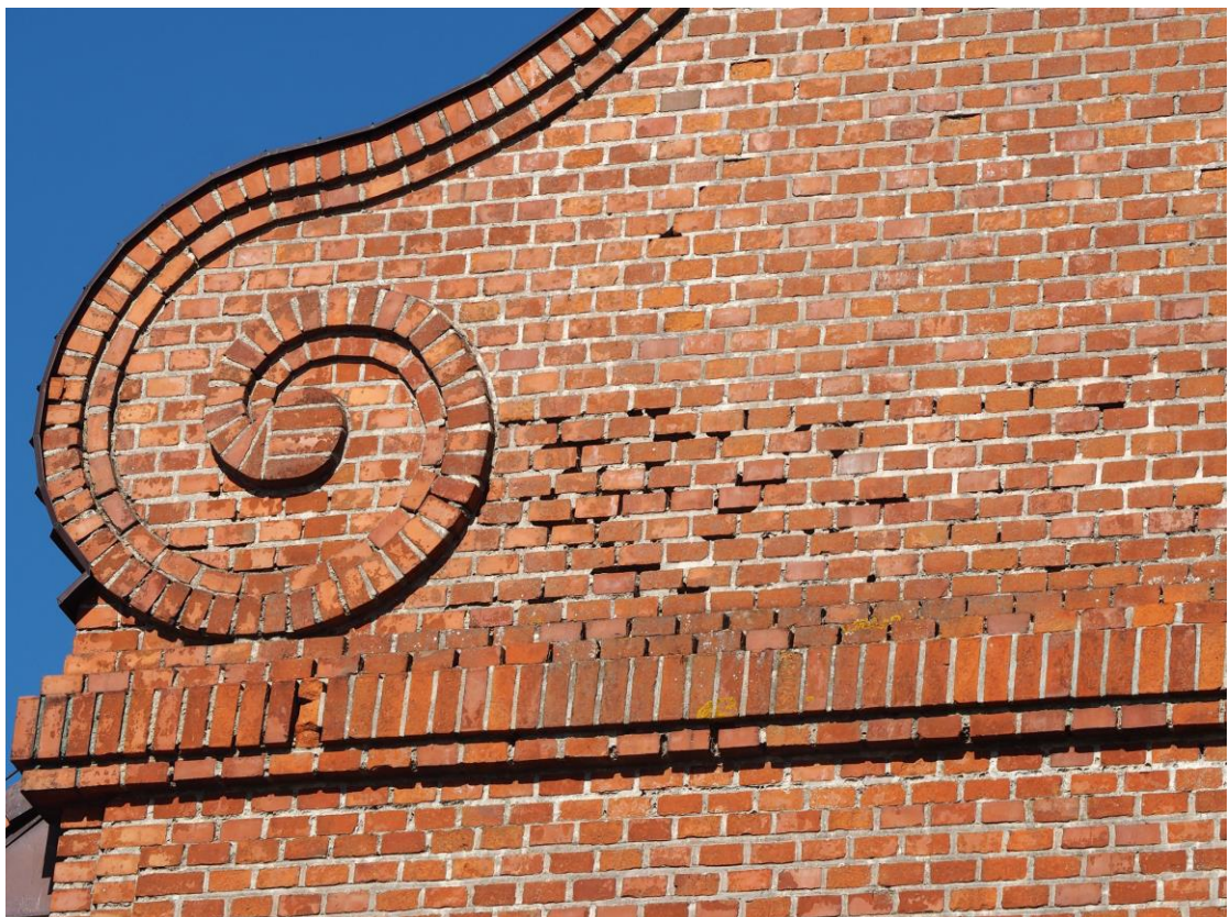
Fot. 18. Wygoda Łączyńska, kościół PW. Św. Józefa. Elewacja zachodnia – fasada. Szczyt, strona północna. Widoczny stan lica ceglanego.
