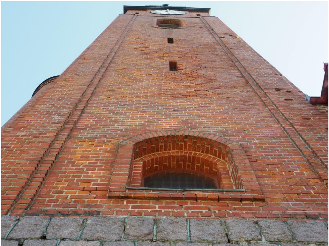
Fot. 23. Wygoda Łączyńska, kościół PW. Św. Józefa. Północna elewacja wieży. Widoczne ubytki zaprawy spoinowej; cegły pozbawione lica; ubytki materiału.
