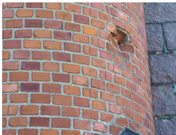
Il. 9. Mechaniczne uszkodzenie cegieł na elewacji wieżyczki schodowej.
