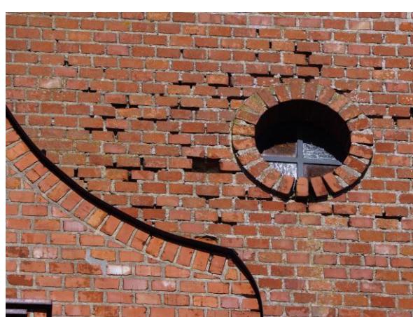
Il. 11. Poważne ubytki zaprawy i cegieł na powierzchni szczytu zachodniego.
