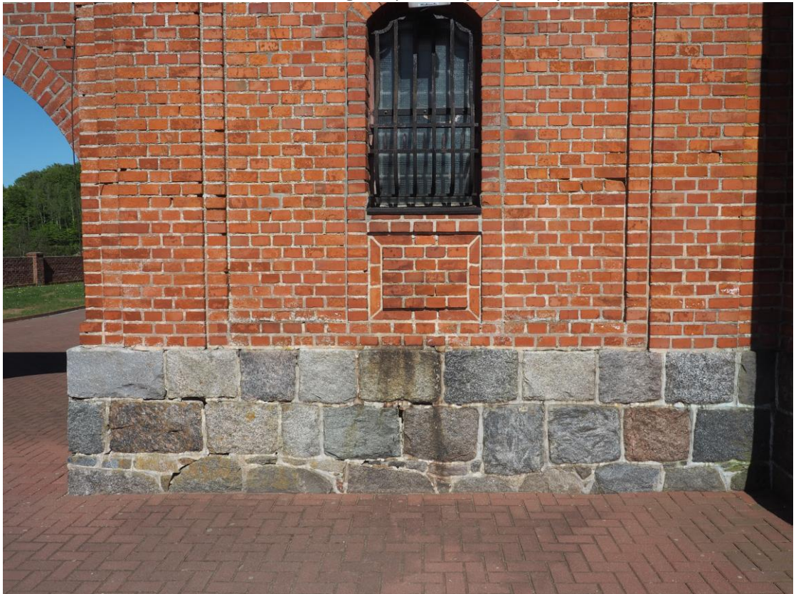
Fot. 9. Wygodza łączyńska, kościół PW. Św. Józefa. Elewacja zachodnia – fasada. Przyziemie, strona północna. Widoczne ubytki zaprawy spoinowej.
