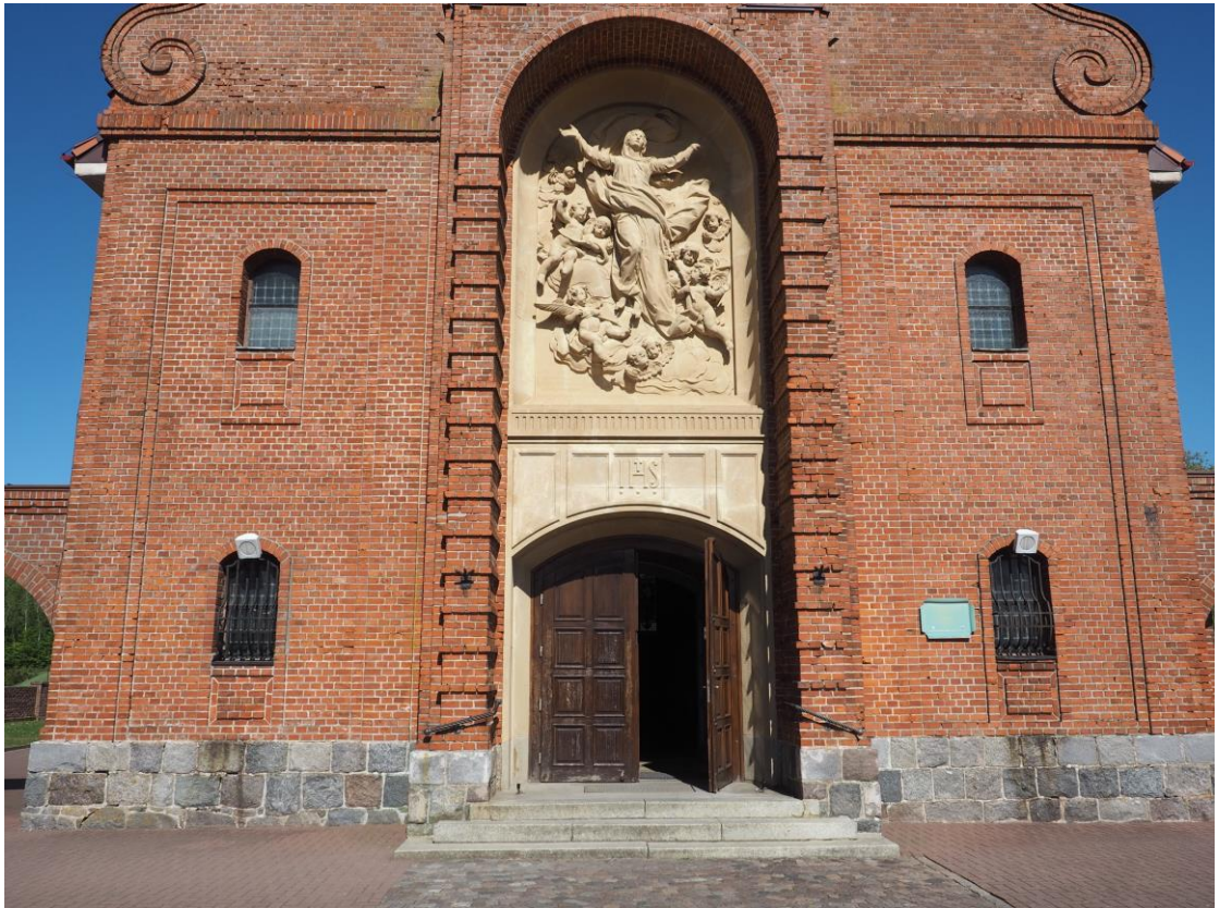
Fot. 8. Wygodza łączyńska, kościół PW. Św. Józefa. Elewacja zachodnia – fasada. Ryzalit środkowy. Widoczne zniszczone lico cegieł w północnej części szczytu.
