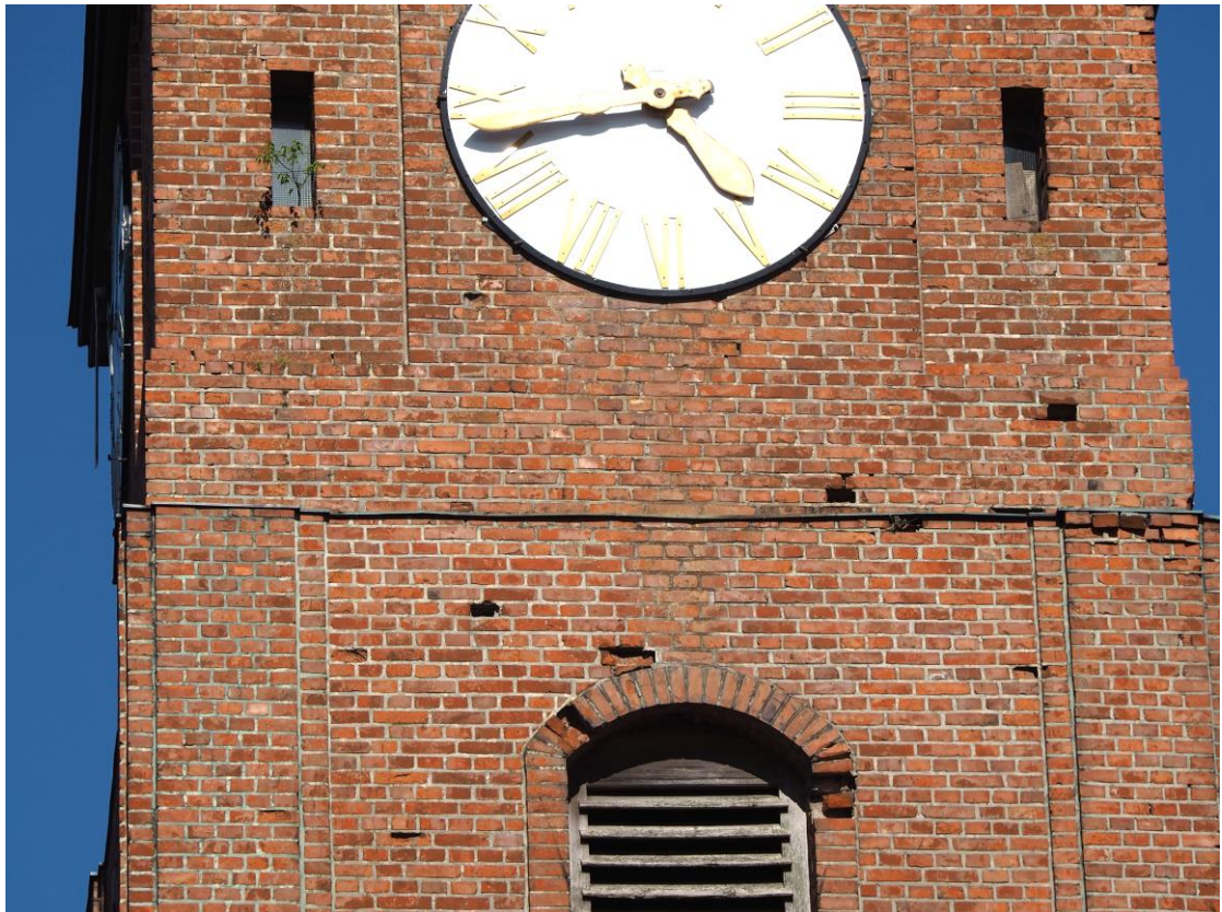
Fot. 25. Wygoda łączyńska, kościół PW. Św. Józefa. Zachodnia elewacja wieży. Kondygnacja V-VI. Widoczne ubytki materiału; rośliny zielne na podokiennikach.
