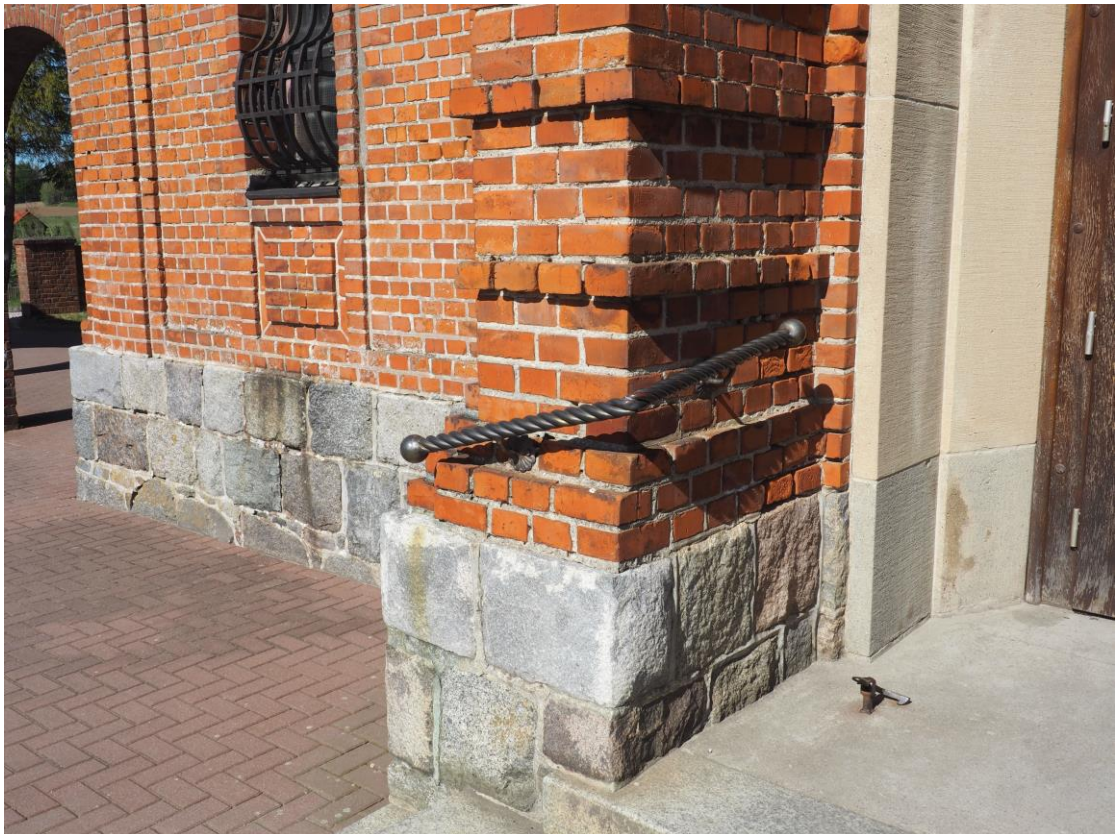
Fot. 10. Wygoda łączyńska, kościół PW. Św. Józefa. Elewacja zachodnia – fasada. Północne ościeże ryzalitu. Widoczne zacieki; kolonie mikroorganizmów.
