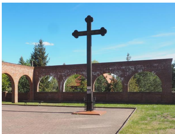
Il. 12. Poważne wysolenia na powierzchni południowego ciągu arkadowego.
