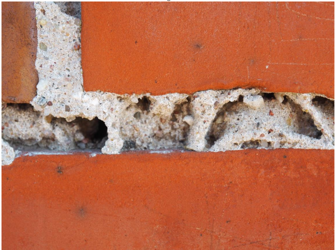
Fot. 20. Wygoda Łączyńska, kościół PW. Św. Józefa. Północna elewacja korpusu – detal. Widoczny stan za- prawy spoinowej.
